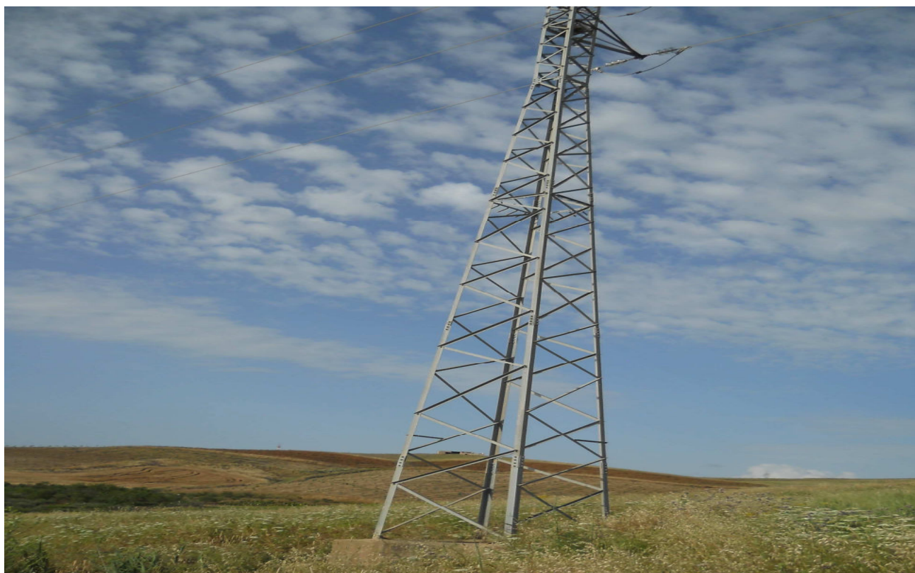
Foto 10 Torre di elettrificazione rurale
